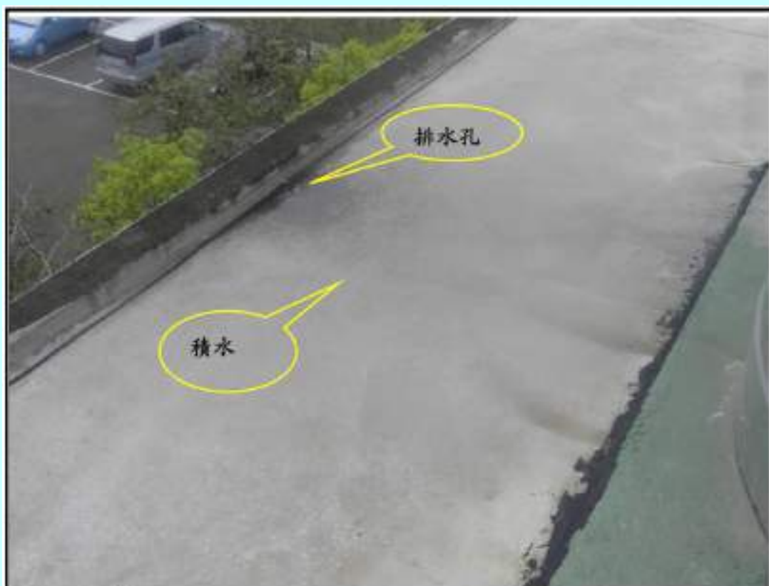
照片 5 | 南棟三樓教室屋頂邊緣排水孔旁有積水
